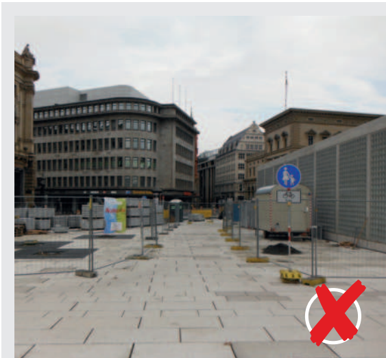
Bild 3 | schlecht sichtbare Abspernung
