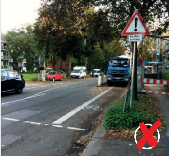
Bild 14 | Arbeitsstelle auf Radfahrstreifen ohne Absicherung
